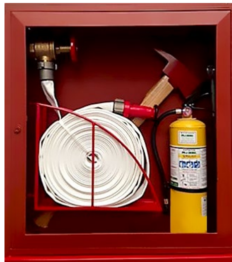
Red contra incendios piso 1
